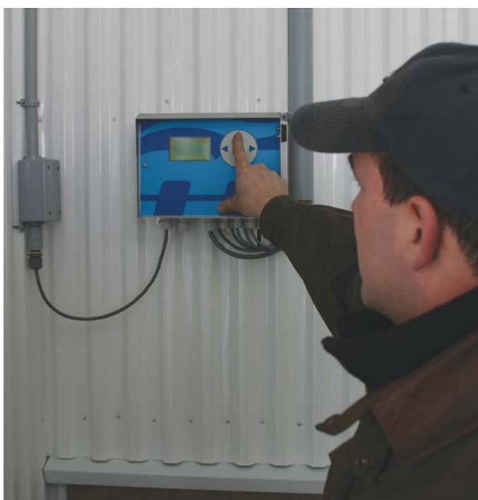
Température de l'eau de lavage, température du bassin refroidisseur, concentration du savon, voilà quelques éléments que le thermographe permet de contrôler.
